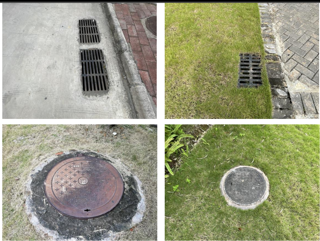
永久办公生活区排水系统
